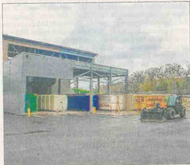
Le centre de transfert des déchets est désormais implanté sur le site du Grenouillet.
